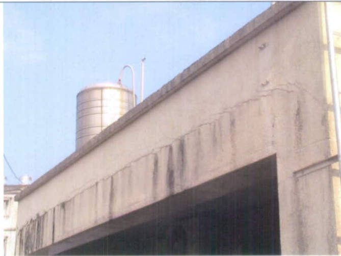
億達煤礦(三合煤礦本坑)塌陷處住家之門柱龜裂
