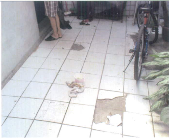
八堵煤礦-高銀城老先生家地板隆起與龜裂
