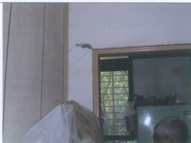
芳川煤礦萬芳路7號本區持續有地表沉陷現象(洗車坊屋內及水泥地面亦有地表龜裂)-1
