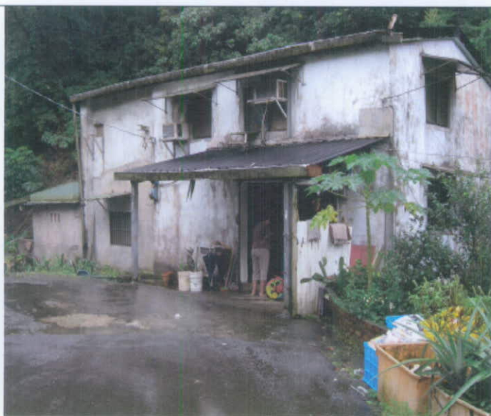
建義-平和-永福煤礦簡文章老先生家屋舍及路面有持續下陷情形
