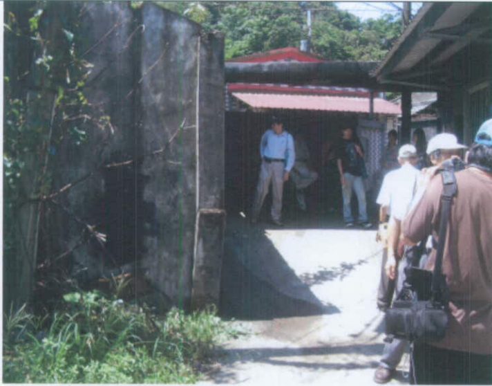
八堵煤礦羅萬礦長家外側屋樑已傾斜 -7
