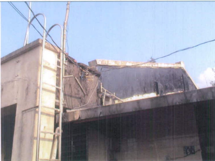
億達煤礦(三合煤礦本坑)塌陷處住家之牆壁龜裂已自行修補
