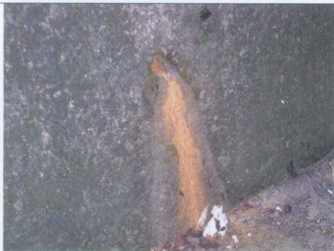
東運瓷土礦旁工廠對面護坡擋土牆有 銹水及龜裂現象
