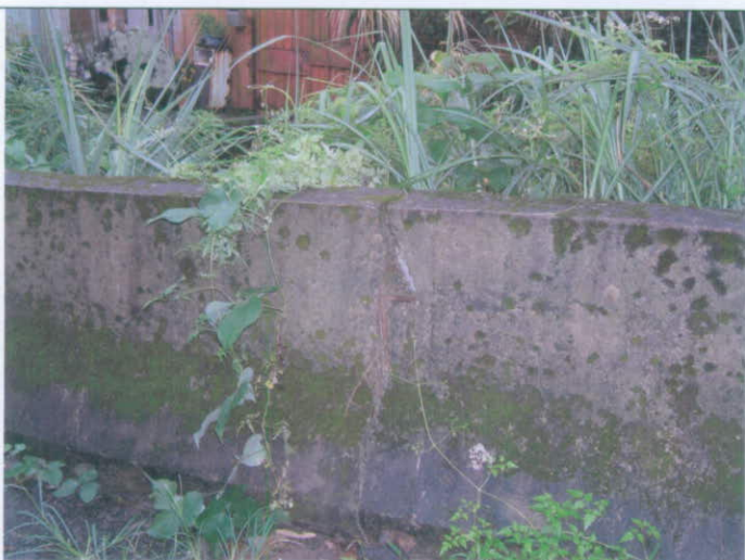
東運瓷土礦採掘跡附近侯溪泉住家對面橋樑龜裂塌-14
