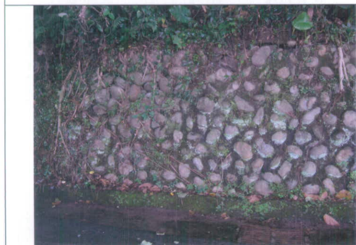
東運瓷土礦採掘跡上方路編舊駁坎已出現裂痕
