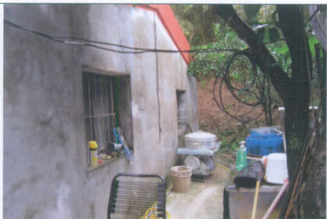
建義-平和-永福煤礦附近住宅牆壁龜裂
