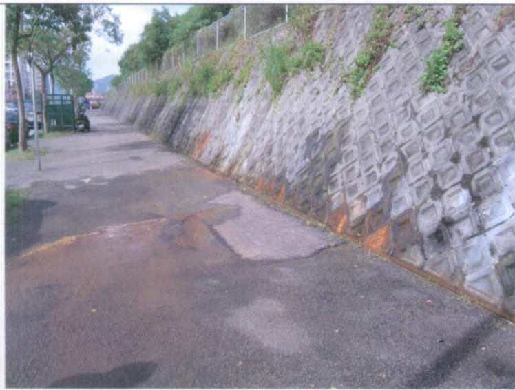
豐田煤礦旁擋土牆有部份湧出銹水遠照(近處之擋土牆排水孔無排水情形)
