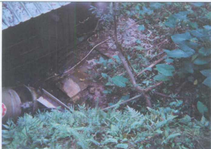
億達煤礦(三和煤礦一坑)-附近新增一風坑口,周圍廢棄舊房舍下方受湧出銹水排入其屋後
