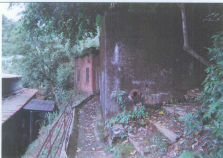
億達煤礦(三和煤礦一坑)-附近新增一風坑口,周圍廢棄舊房舍位處陡坡側,且結構不良
