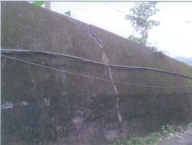
東運瓷土礦旁之擋土牆已發生龜裂且 向內凹陷(遠照)
