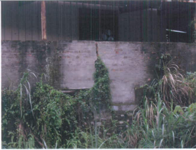
東運瓷土礦採掘跡附近住家圍牆已龜裂-1
