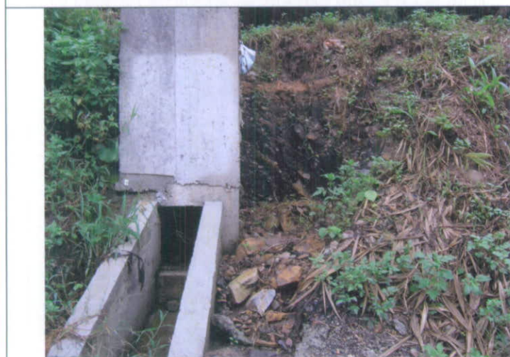
東運瓷土礦採掘跡上方路旁排水溝亦出現零星之邊坡塌陷
