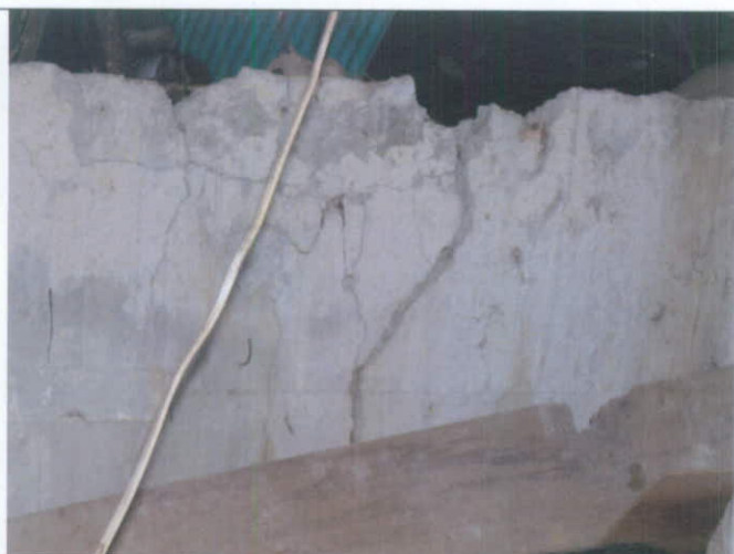
東運瓷土礦採掘跡附近侯溪泉住家圍牆已龜裂-3
