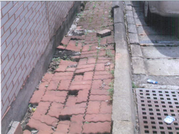
木南煤礦南湖坑採掘跡附近道路之小範圍之塌陷-1
