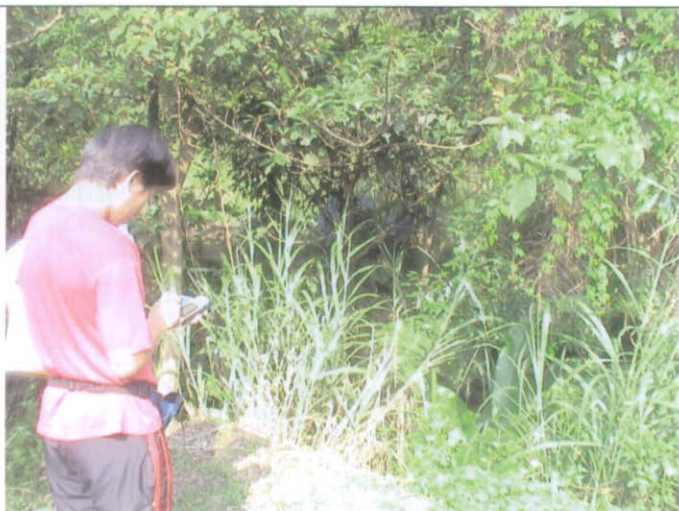
中台福基煤礦-新坑口之坑道上盤已崩陷
