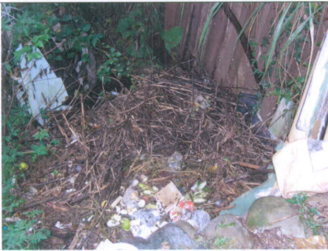
東運瓷土礦採掘跡附近侯溪泉住家上坡小路之舊塌陷地(以鐵板支撐)圍牆已龜裂-8
