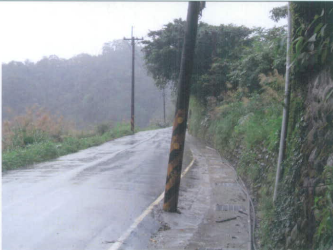
炭腳煤礦旁電線桿傾斜, 持續發生
