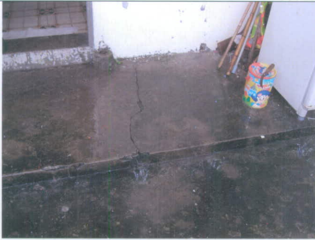
炭腳煤礦郭林秀屋前舊屋舍亦有多處 裂縫-4
