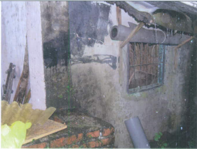
炭腳煤礦郭林秀屋前舊屋舍亦有多處 裂縫-1
