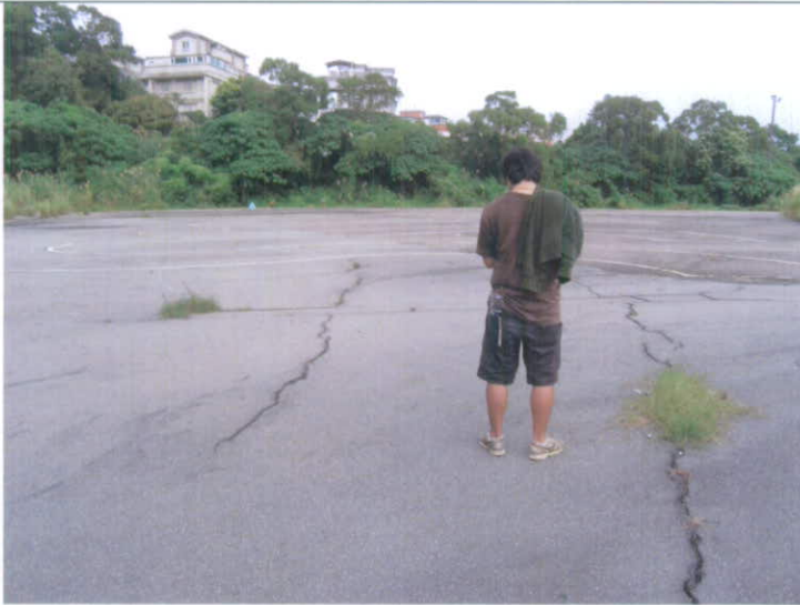
豐田煤礦坑口上方舊訓練場有大型裂縫近照
