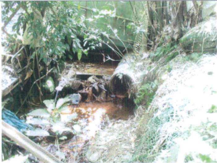
八堵煤礦蔡甲乙老鄰長家屋後擋土牆施工蝕造成淺層地表龜裂湧出銹水-1
