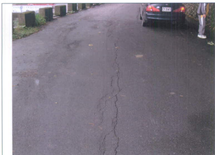
東運瓷土礦採掘跡上方路面邊坡仍有滑動現象造成路面大範圍龜裂
