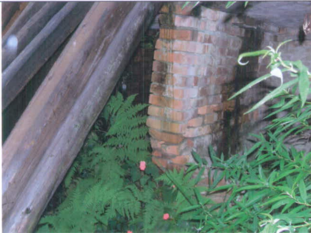
東運瓷土礦採掘跡附近侯溪泉住家上坡路面之圍牆傾塌-11
