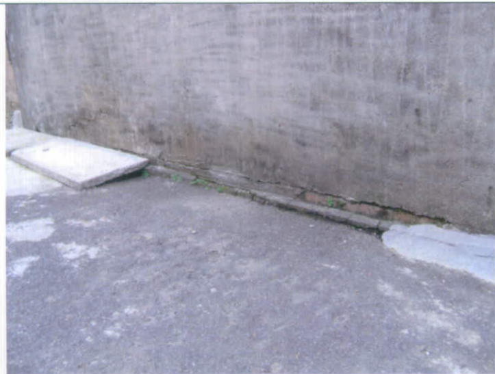
瑞松街 40 號位於烘內坑煤礦(舊本坑-火鼎坑)前方, 房舍牆壁及樑柱龜裂且地基有下沉現象-3
