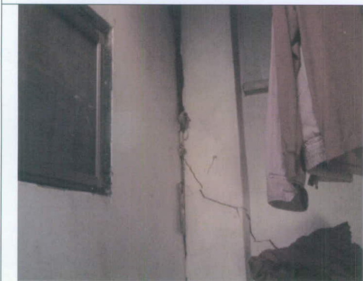
八堵煤礦附近住家樑柱裂縫-2
