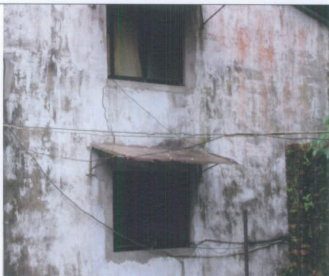
建義-平和-永福煤礦簡文章老先生家屋舍及路面有下陷, 牆壁龜裂
