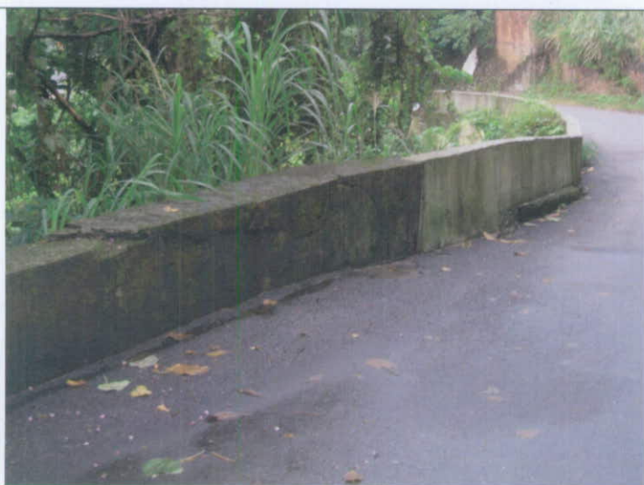
東運瓷土礦採掘跡上方路面邊坡仍有滑動現象造成水泥牆龜裂
