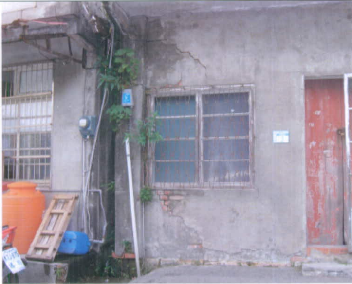
位於烘內坑煤礦(舊本坑-火鼎坑)採掘跡附近舊房舍牆壁及樑柱龜裂
