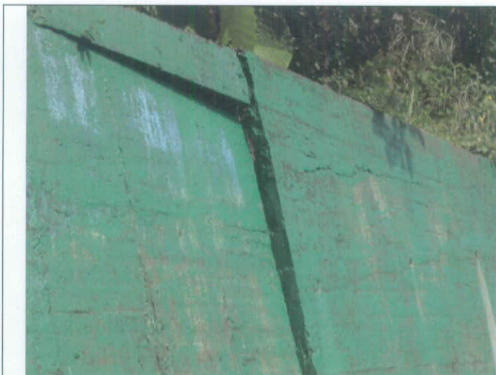
八堵煤礦附近擋土牆部份向內側裂凹 近照
